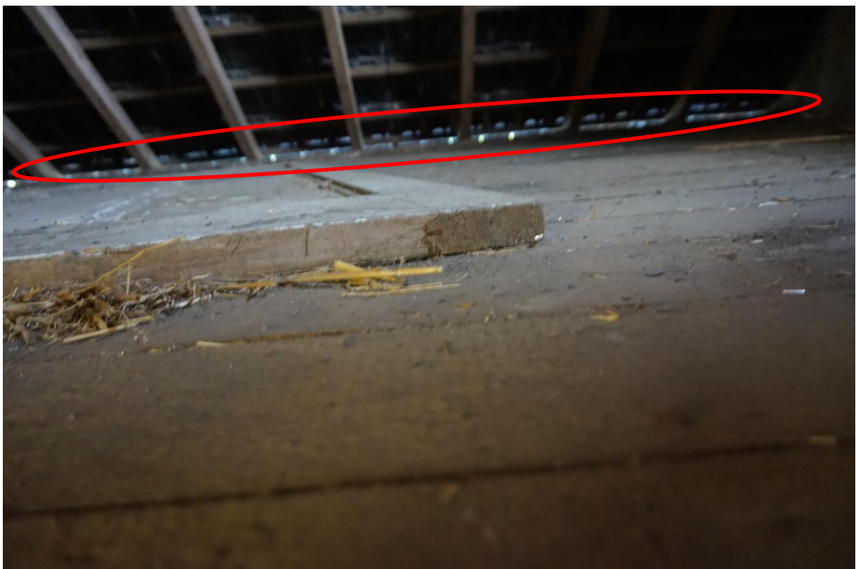
Figuur 5.7 Tocht kan de schuur binnentrekken door ruimte tussen dakpannen en muur (rood omcirkeld).
