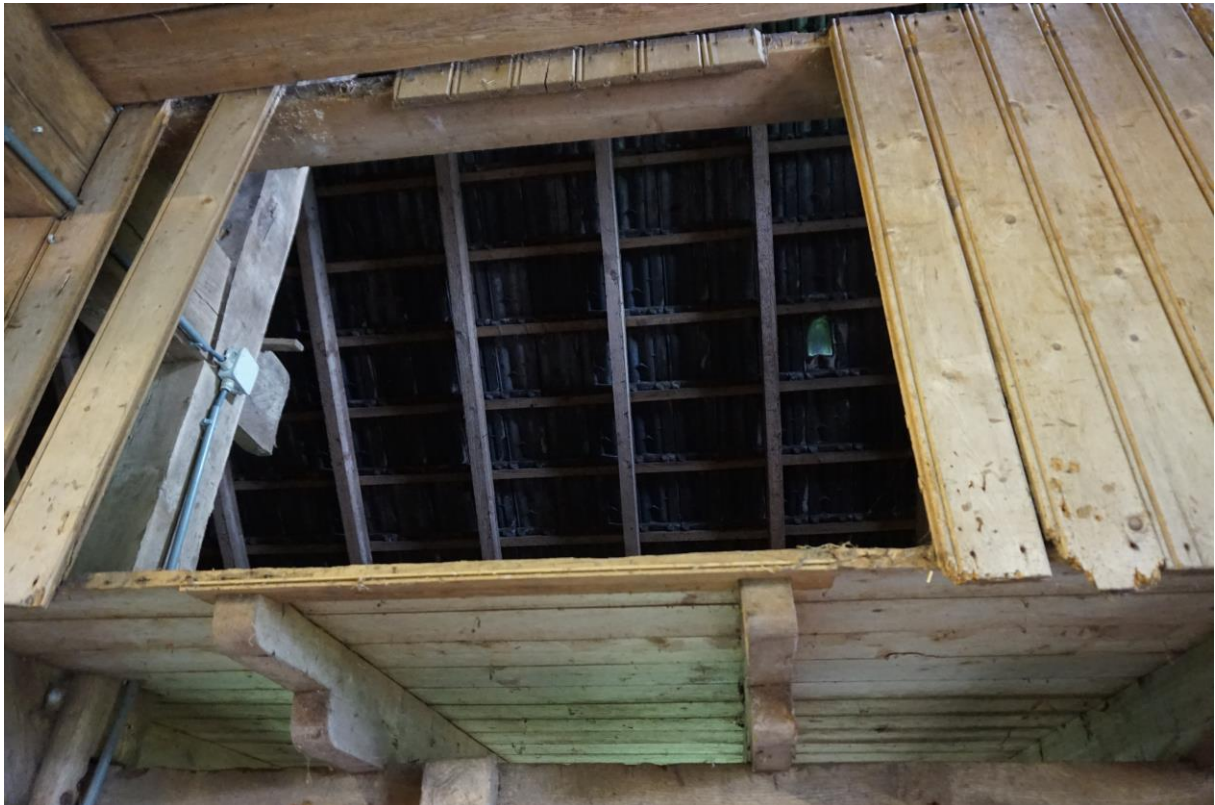
Figuur 5.6 Dakbeschot ontbreekt waardoor er geen geschikte verblijfplaatsen voor vleermuizen aanwezig zijn.
