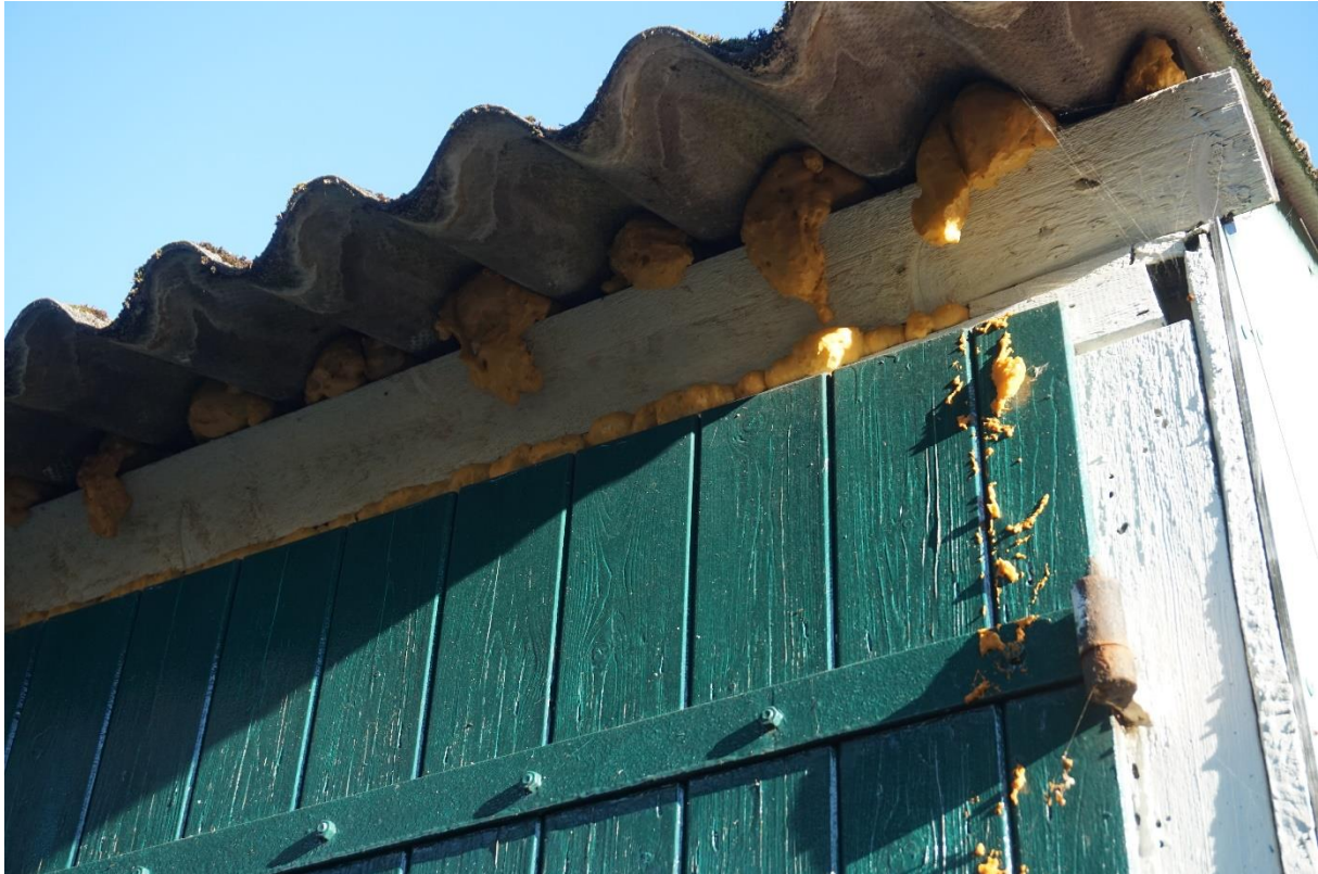
Figuur 4.5 Potentiële toegangslocaties voor vleermuizen zijn dicht gepurd.
