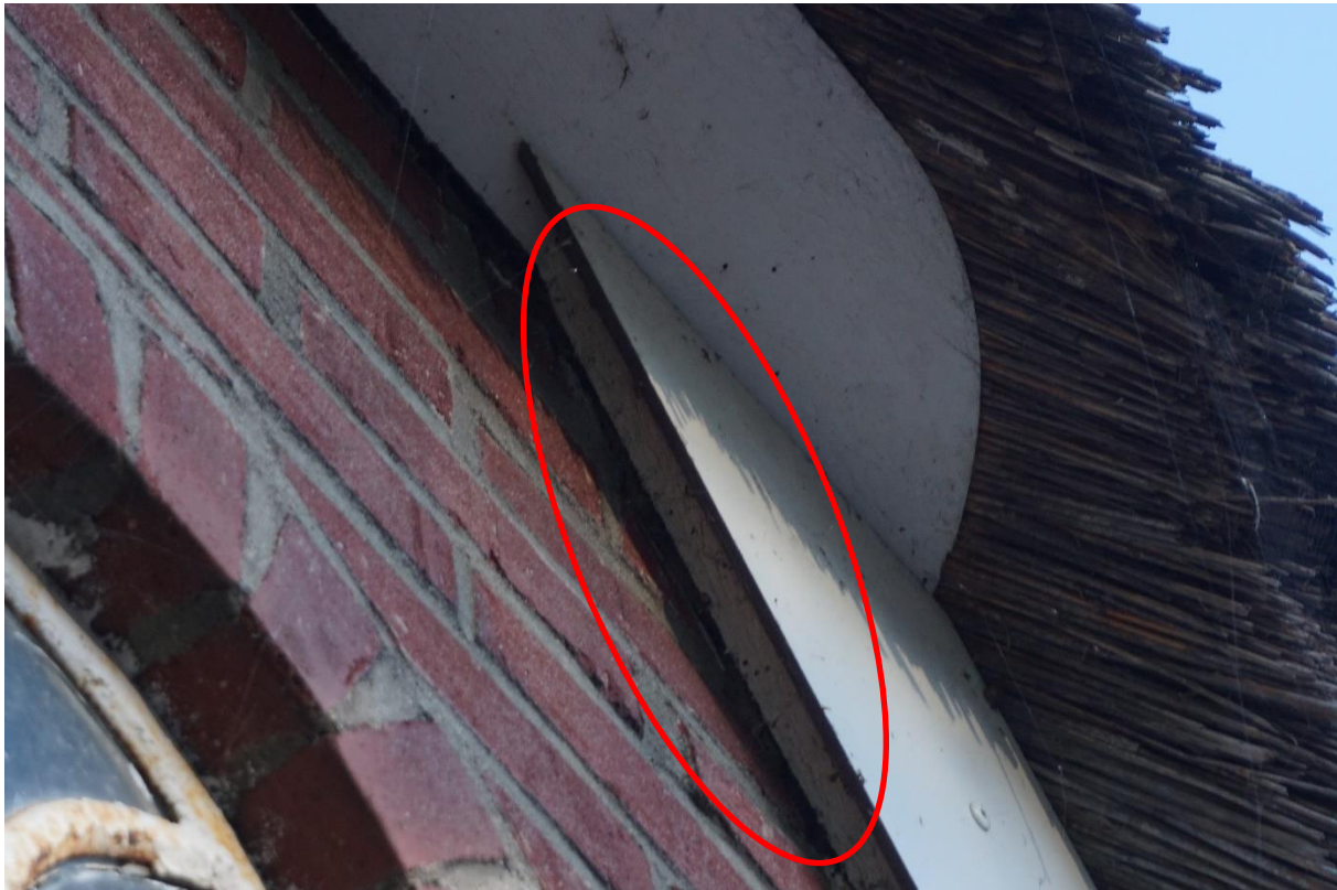
Figuur 4.4 toegang voor vleermuizen tussen gevel en het dakoverstek
