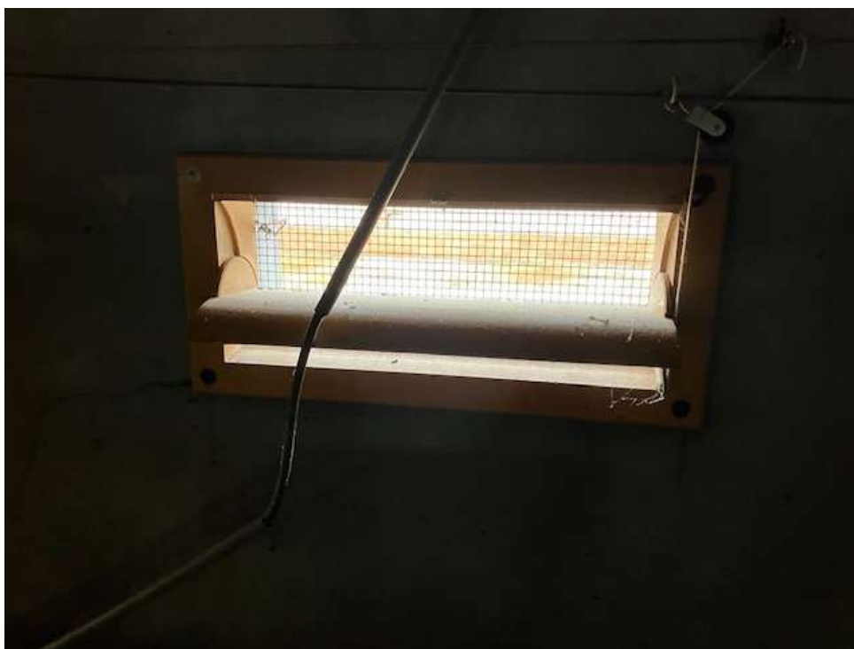
• Afbeelding 6: Luchtinlaatventielen van de stallen zijn voorzien van gaas
