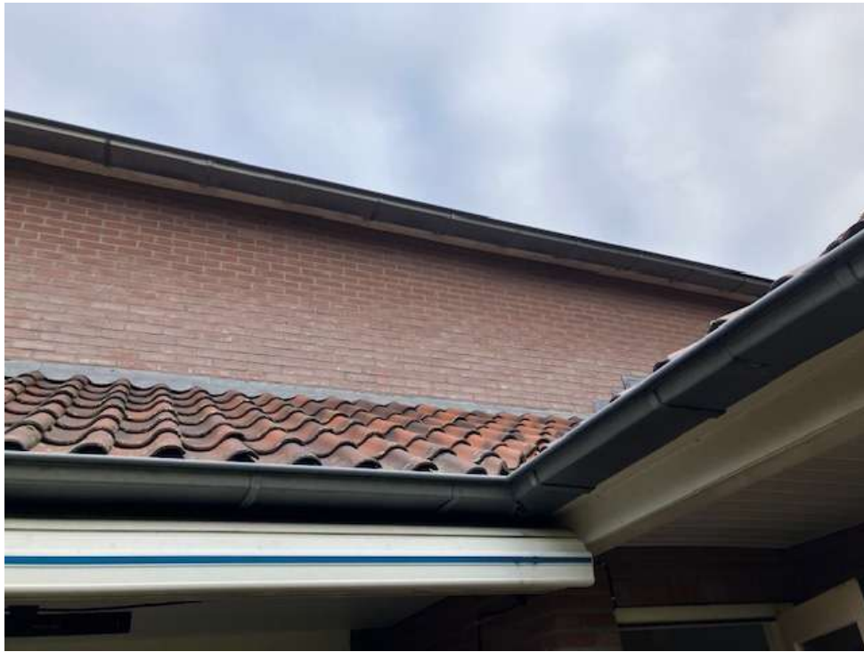
• Afbeelding 27: onderzijde dakrand aan achterzijde woning
