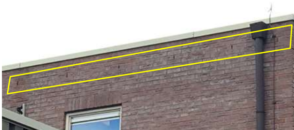
Open stoorvoegen in de buitengevel van een gebouw in het plangebied. De open stoorvoegen vormen een potentiële invliegopening voor vleermuizen.
