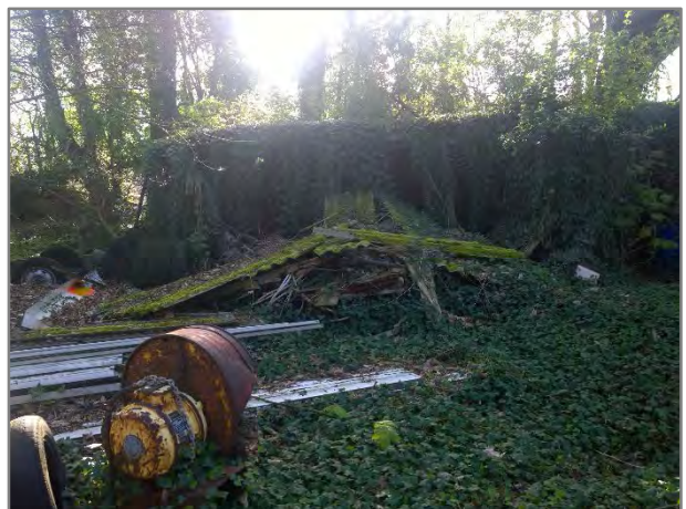
Foto 12: Noordoostzijde (asbestverdachte golfplaten)
