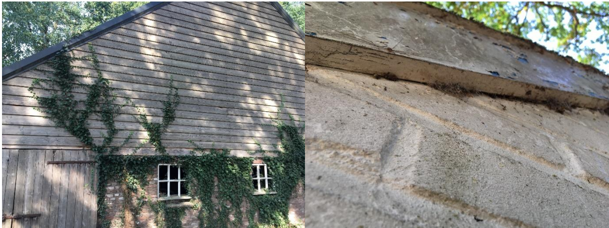
Foto links; de houtbetimmering sluit strak op elkaar aan waardoor er geen kieren ontstaan. Foto rechts; de windveren sluiten strak aan op de buitengevels.
