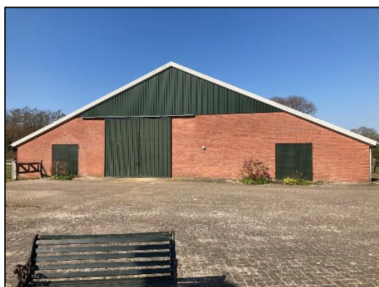
Figuur 2.11 (links): De voorzijde van de manege, de nok wordt gevormd door damwanden op het zuiden. In de muur zijn geen kieren of gaten gevonden waarlangs dieren het gebouw en de spouwmuur kunnen betreden.
