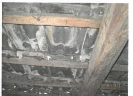
Vorstschade pannen en verspreid afgeroeste vernageling panlatten.
