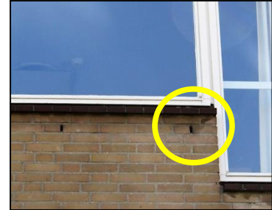
Figuur 6. Open stootvoeg, biedt toegang tot kraamverblijf voor gewone dwergvleermuis.
