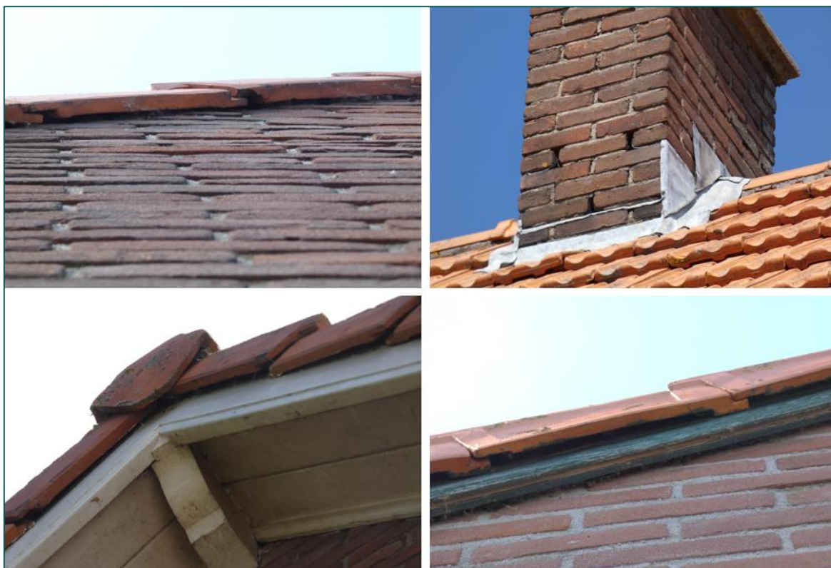
Figuur 3.2 De spouw en open dakruimte van de woning (1) is voor vleermuizen toegankelijk middels kierende kantpannen en open stootvoegen. De dakruimte van de voormalige stal (3) is tevens toegankelijk middels kierende kantpannen (foto rechts onder).
