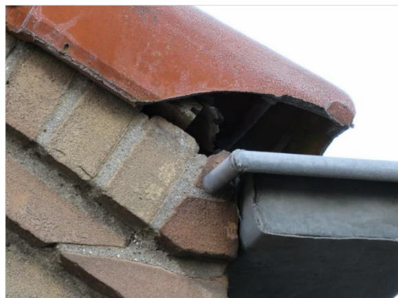
Figuur 5.4 Afgebroken dakpan en ruimte onder de dakpannen van woningen aan de Hessenbergstraat te Zetten.
