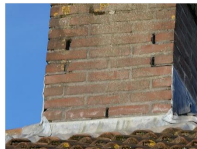
Figuur 5.15 Open stootvoegen in de schoorstenen van de woningen aan de Ploegstraat te Zetten.
