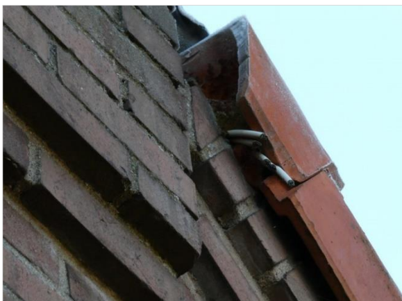
Figuur 5.3 Nestmateriaal onder een afgebroken dakpan van woning aan de Hessenbergstraat te Zetten.
