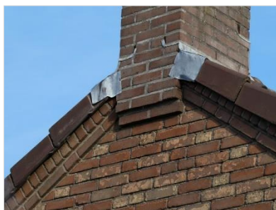
Figuur 5.11 Spleten onder de dakpannen en onder de loodslabben aan de Hoofdstraat te Herveld.
