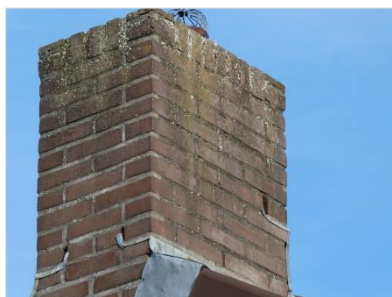
Figuur 5.10 Open stootvoegen in de schoorstenen van de woningen aan de Hoofdstraat te Herveld.
