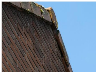
Figuur 5.14 Spleten onder de dakpannen van de woningen aan de Ploegstraat te Zetten.
