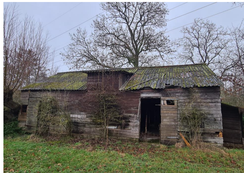
Figuur 7: Vervallen schuur in het zuiden van het plangebied
