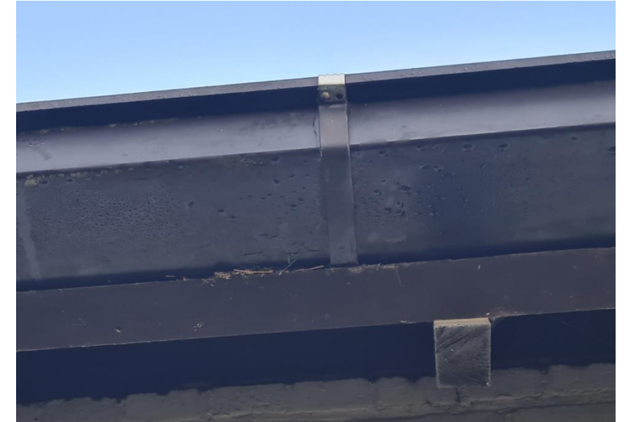
Figuur 9: Zichtbaar nestmateriaal tussen overstek en dakgoot
