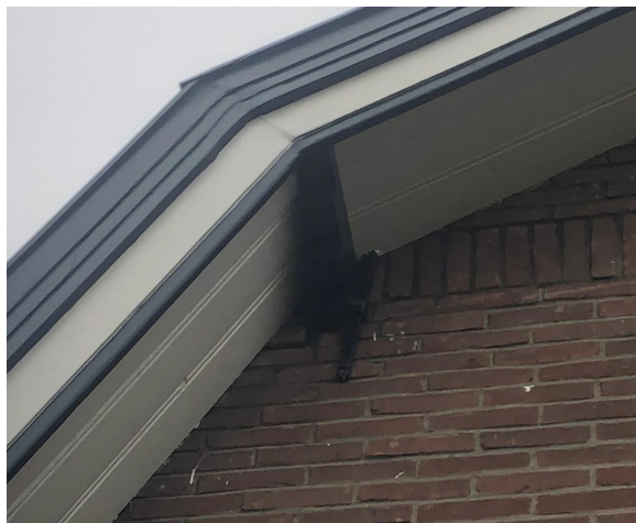
Figuur 4: uitgebokkelde voegsel op meerdere plekken aan de randen van het dak.
