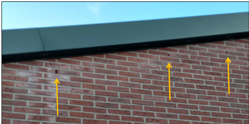
Open stootvoegen bij de dakrand van de gevel aan de noordzijde
