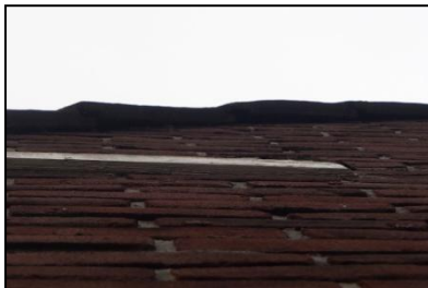
Figuur 11. Overhangende dakpannen.
