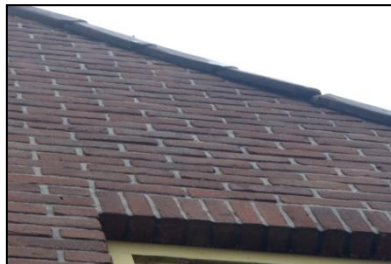
Figuur 12. Overhangende dakpannen.
