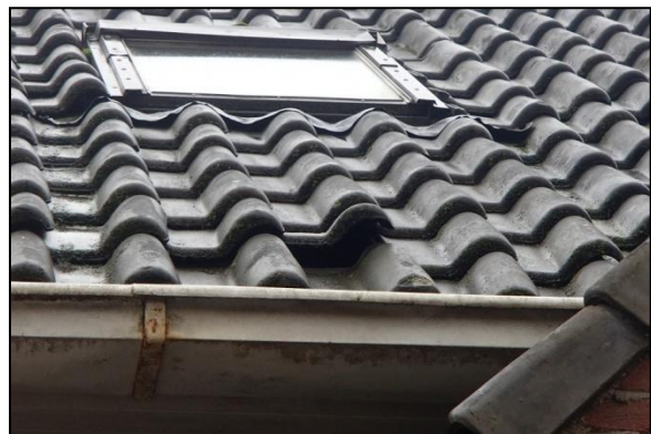
Figuur 10. Losliggende dakpan.
