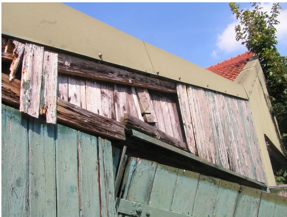
Figuur 3. Zijaanzicht van dezelfde schuur; de kapotte betimmering biedt ruimte voor verblijfplaatsen van vleermuizen.
