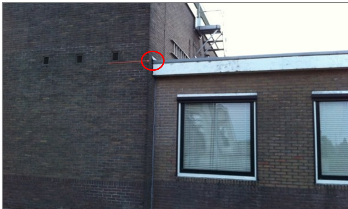
Invliegopening loodflap achterzijde bedieningsgebouw.
