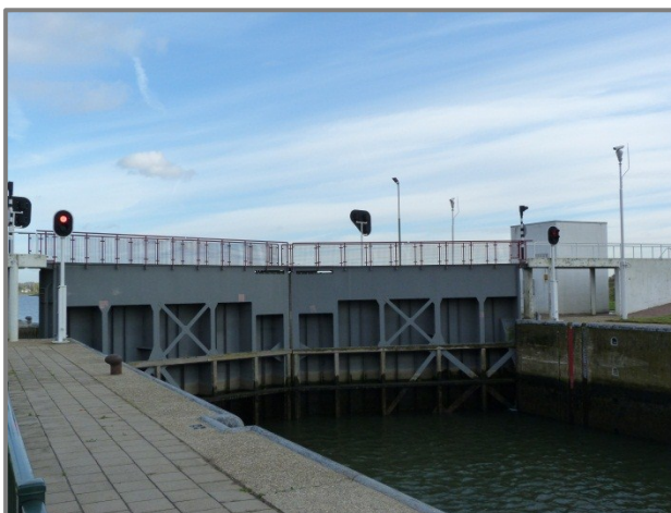
Sluisdeuren met verblijfsmogelijkheden voor vleermuizen en broedvogels.
