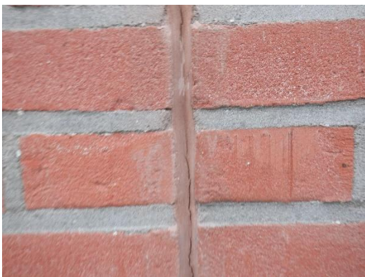
Foto niet verdachte kit in de gevel
