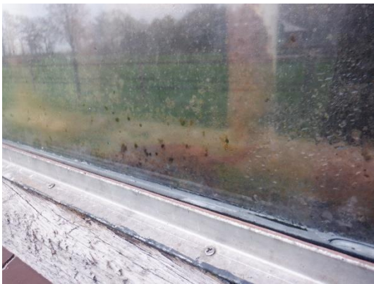
Foto niet verdachte raamafwerking
