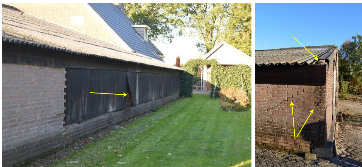
Figuur 8 Voorbeelden van de slechte staat van onderhoud van de aangebouwde stal. Zijplaten staan open en schuren in de wand etc. laten zien dat deze stal zijn beste tijd wel heeft gehad.
