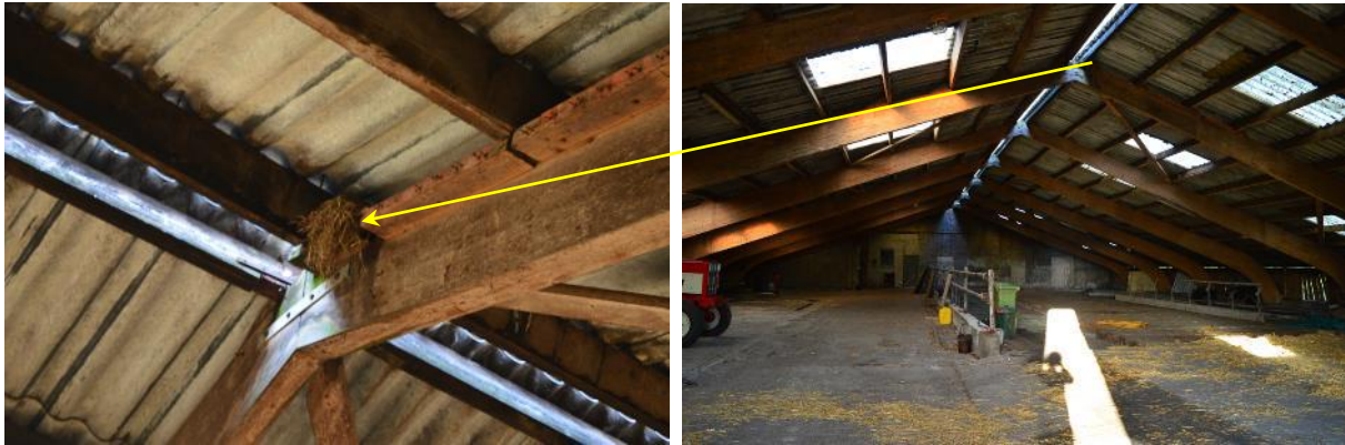
Figuur 9 Voorbeeld van een verlaten nest tegen de dakconstructie van de aangebouwde stal. In deze stal zijn twee van dergelijke plekken aangetroffen. Beide locaties waren niet bezet. Alleen een roodborst vloog even via de kapotte zijwand van de stal naar binnen om vervolgens vrij snel het pand weer te verlaten.
