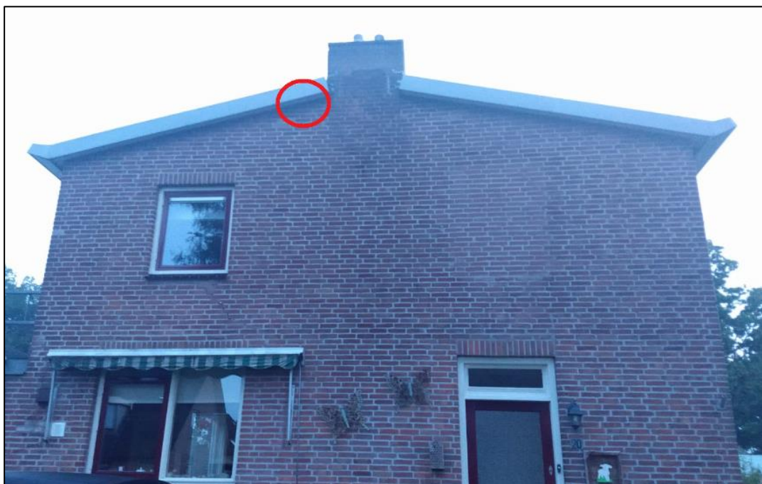
Figuur 43 Zomerverblijf gewone dwergvleermuis Burg Gratamaplein 20 Veenoord
