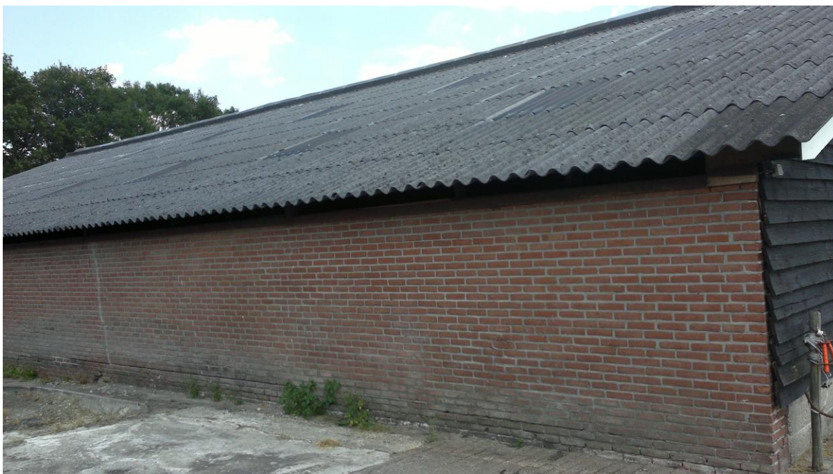
Foto 4: schuur met asbestverdachte dakplaten
