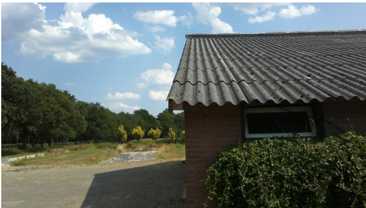
Foto 2: schuur met asbestverdachte dakplaten
