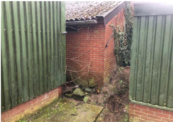
foto 1: korte goot onder asbest verdacht dak
