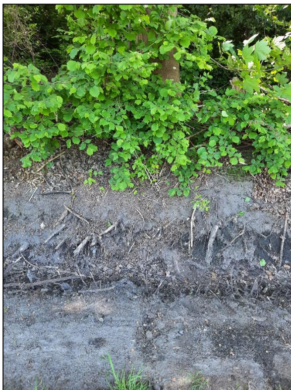
Figuur 15. Wortelschade boom 3.
