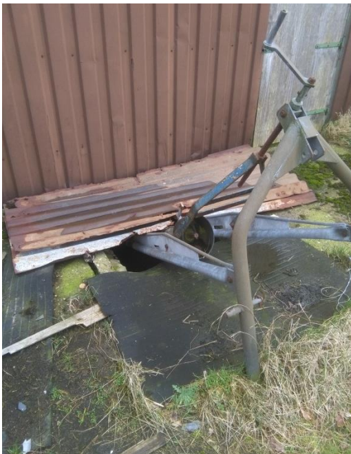
Foto 2: de pompput van de mestkelder onder de meest zuidelijke stal (foto door L.C. Nijdam).
