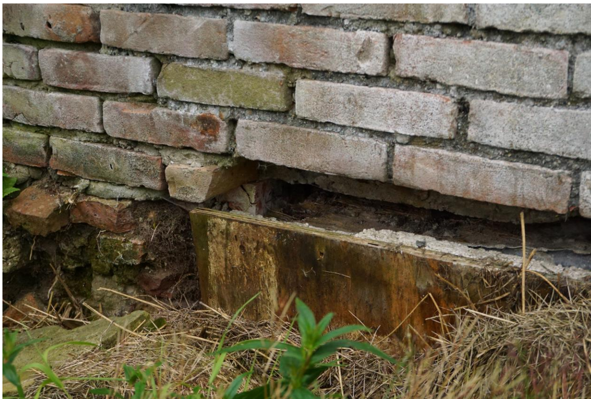
Figuur 4.7 Aan de noordelijke zijde is een opening aanwezig in de gevel, waardoor toegang voor steenmarter is tot het gebouw.
