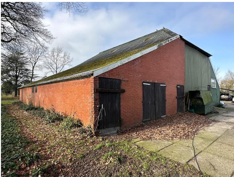
Afbeelding 6. (Opslag)schuur met asbestgolfplaten aan de zuidzijde zonder dakgoten.
