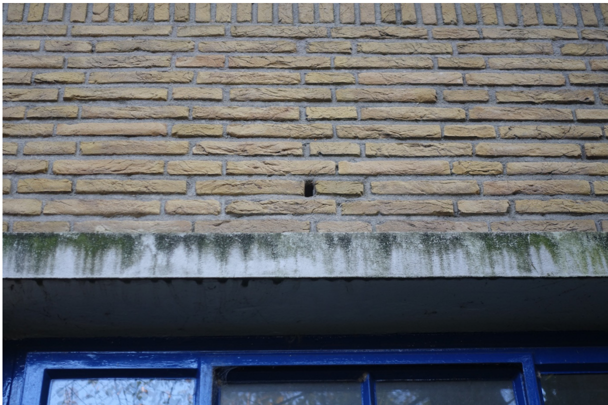
Er zijn veel open stootvoegen aanwezig. Via deze openingen kunnen vleermuizen de spouw bereiken.
