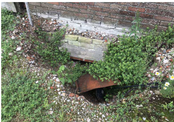
Figuur 9. Pal achter de dieseltank, aan de buitenzijde van de westelijke schuur is een opening (zinkgat) die toegang geeft tot de gierkelder.
