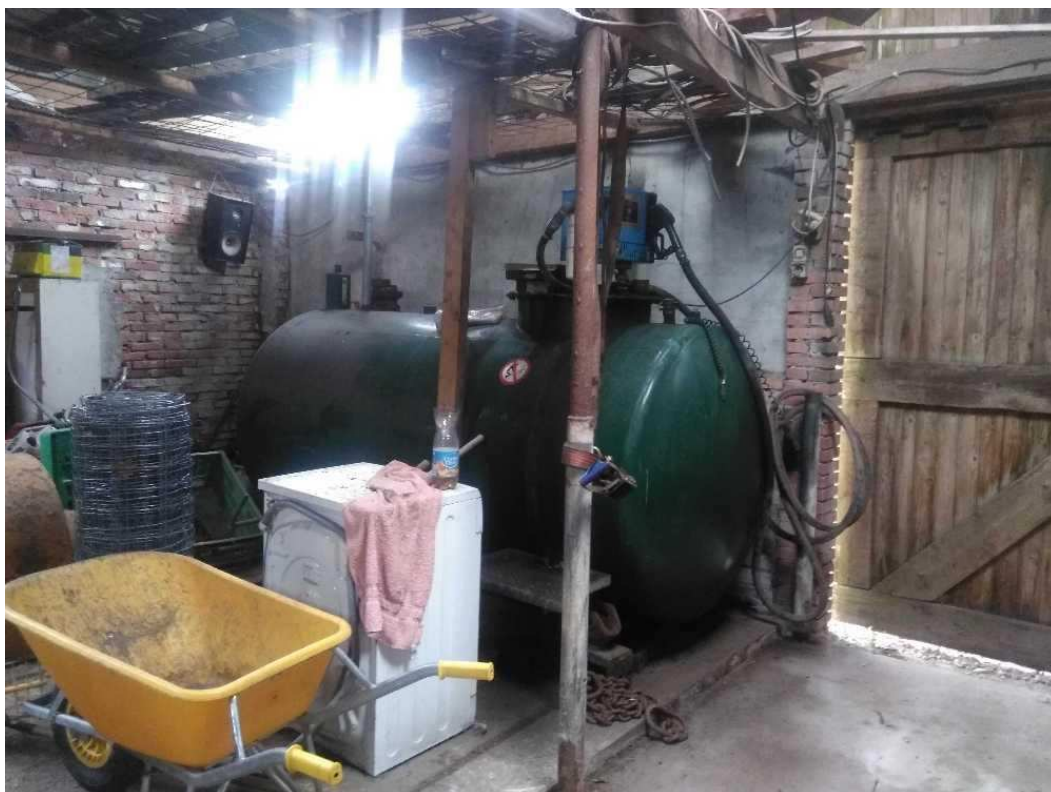
Foto 6. Tank in opslag schuur Pelincksweg 1B.
