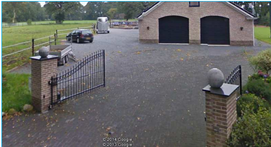
Het hekwerk – is circa 1 meter te hoog
