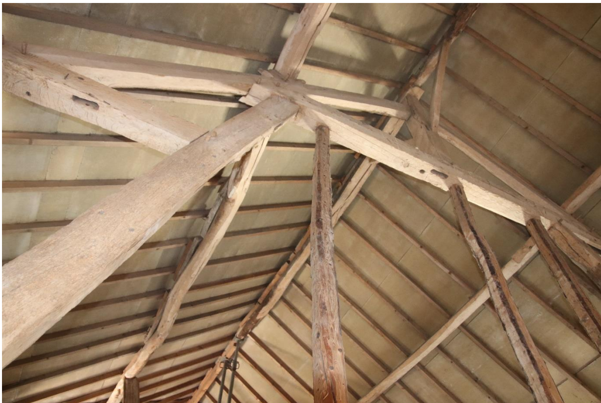
Foto 2: Beeld van de binnenzijde, waar de asbestplaten zichtbaar zijn. Deze ruimte wordt omgebouwd tot een woonbare eenheid, waardoor het asbest verwijderd dient te worden.
