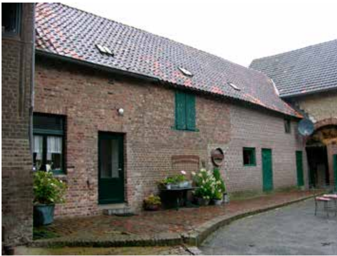
16. De binnenplaatskant van de vleugel met de diverse fases in de vervanging van het metselwerk. Alleen het stuk achter de planten is authentiek, de rest is vernieuwd
