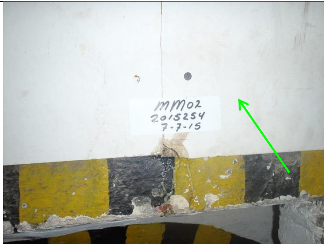
Foto nr. 4, 5 en 6: Brandwerend plaatmateriaal
