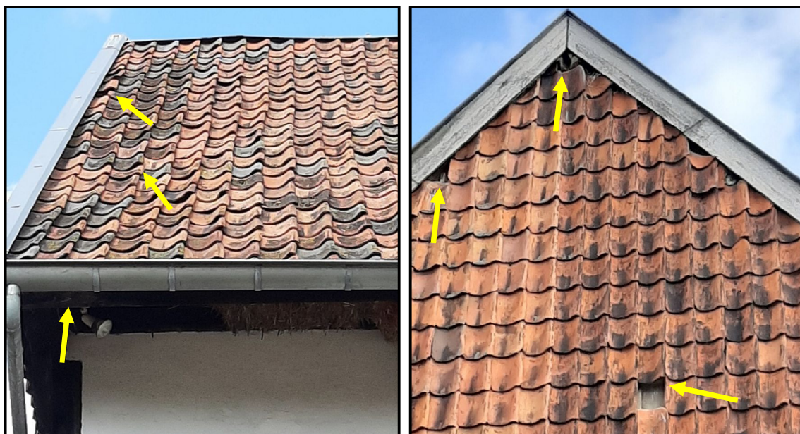
Figuur 4.1 Weergave locaties met gele pijl waar potentiële verblijfplaatsen vleermuizen aanwezig zijn ter plaatse van onderbrekende dakpannen, scheef liggende dakpannen en onder boeiboorden.
