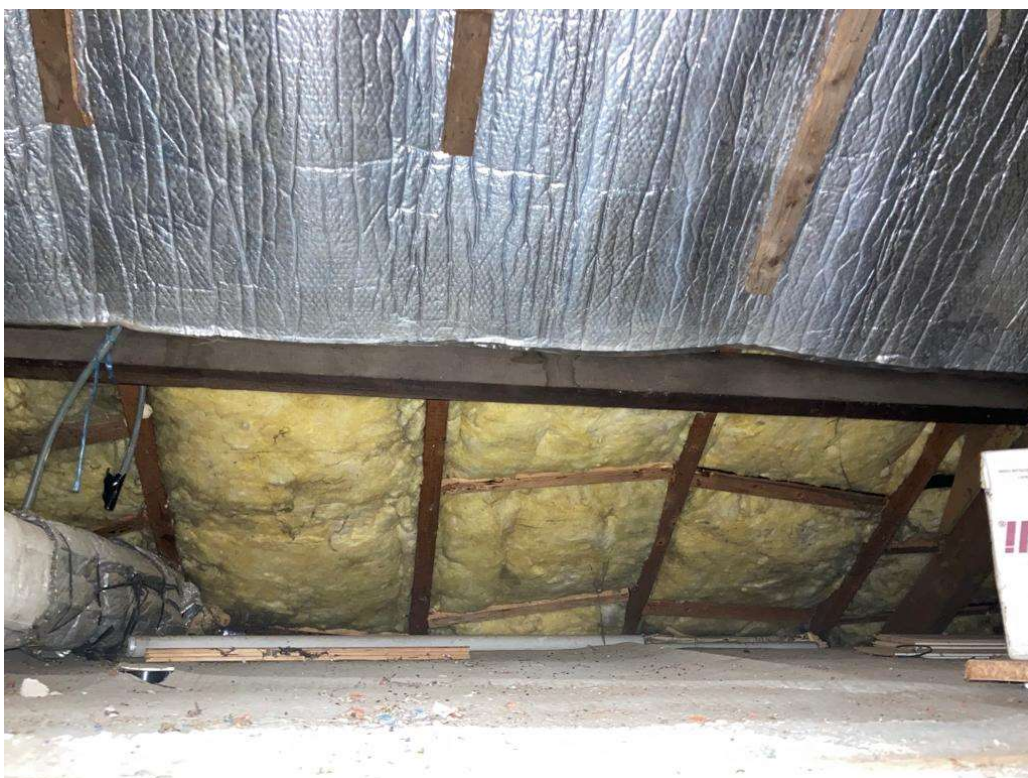
• Afbeelding 14: Zolder boven bijgebouw, isolatiemateriaal tussen de gordingen
