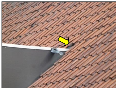
Figuur 10. Ontbrekende dakpan in het woon/winkelpand die toegang verleend tot ruimte onder het dakbeschoot.
