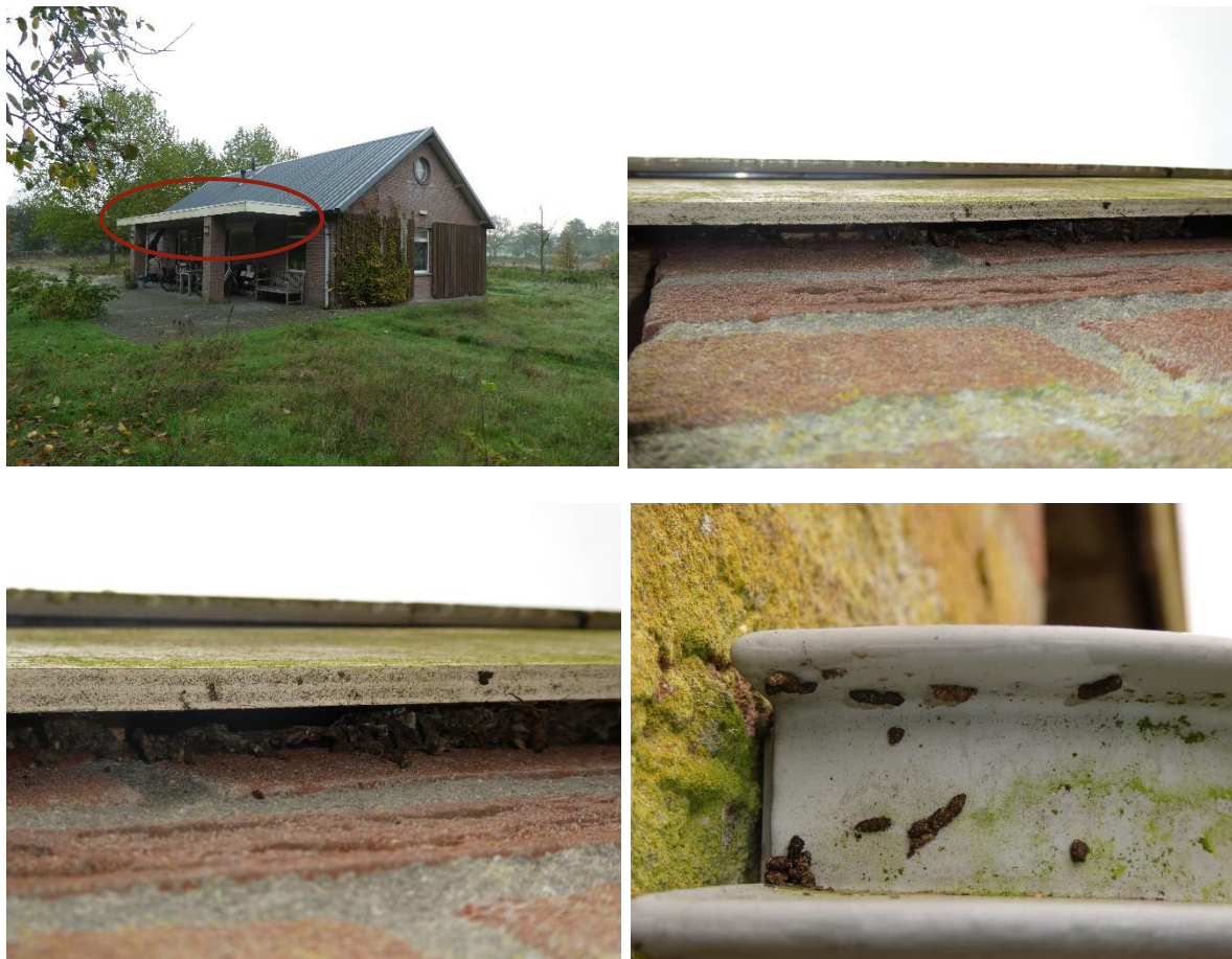
Afbeelding 15 t/m 18: vleermuisuitwerpselen achter overkapping in te slopen bijgebouw. Bron: BNL advies. Datum: 31-10-2022
