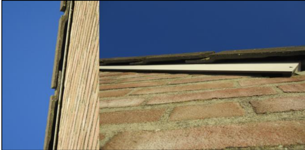
Figuur 4 Kierende kantpannen en een kierende daklijst leiden mogelijk tot potentiële verblijfplaatsen van vleermuizen.
