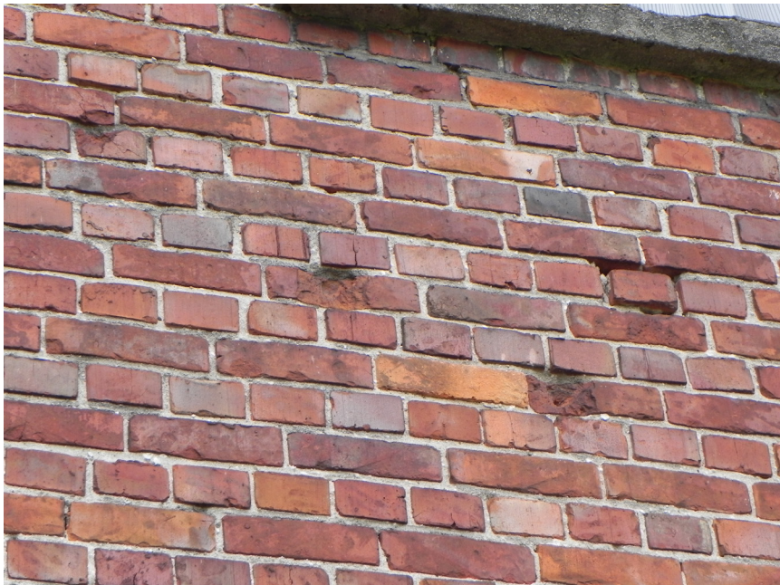
38. Kogelgaten in het metselwerk van de oostgevel. JvL 2015.
