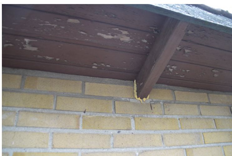
afgepurde aansluiting dak/wand
