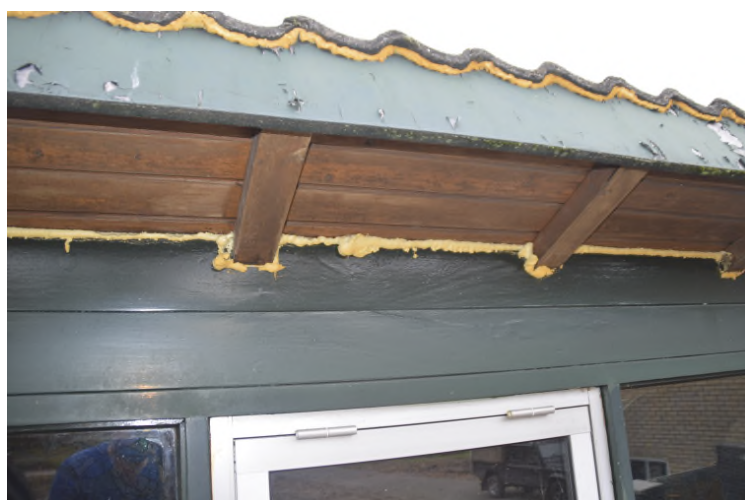
afgepurde aansluiting dak/wand
