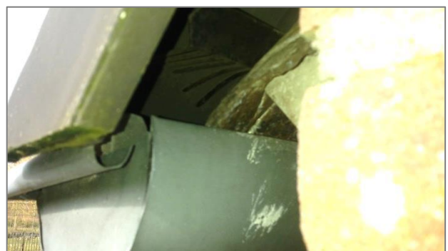
Afbeelding 2.8 | Vogelschroot achter de dakgoot van het hoofdgebouw.
