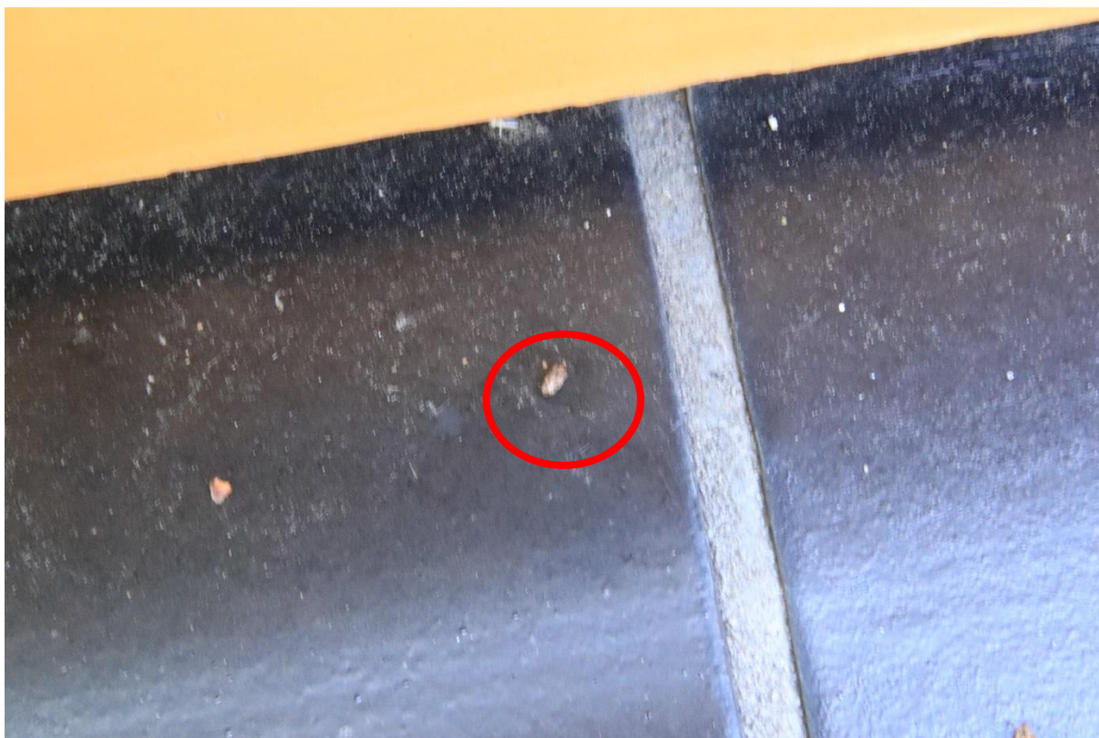
Foto 4: Aangetroffen vleermuismest. De te amoveren woningen kunnen als vaste rust- en verblijfplaats dienen voor vleermuizen. Nader onderzoek is dan ook noodzakelijk om hier een gedegen uitspraak over te doen en een gedegen effectbeoordeling en toetsing te kunnen verrichten
