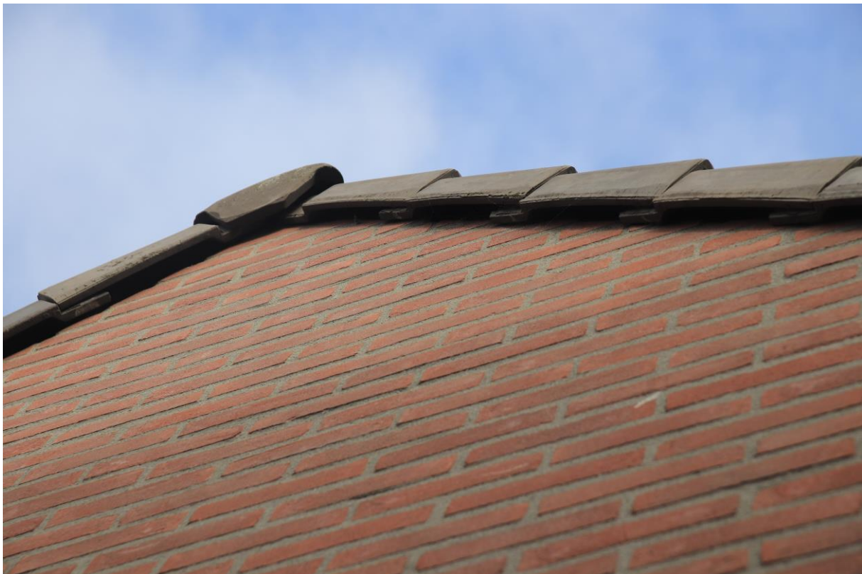
Foto 2: het pannendak lijkt openingen te bieden, echter is de isolatie zichtbaar vanaf de onderzijde. Dit geeft nergens verder toegang tot de constructie.
