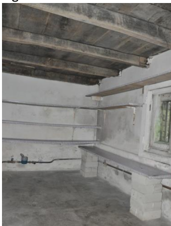
Afb.23. Kelder rechts raam met diefijzers.
