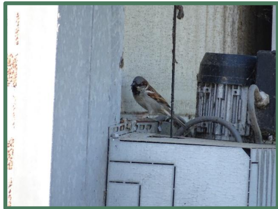
Foto 16: Huismus bij transformator
