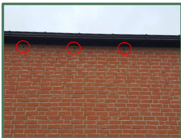
Open stootvoegen Hondsbosserdijk 1a
