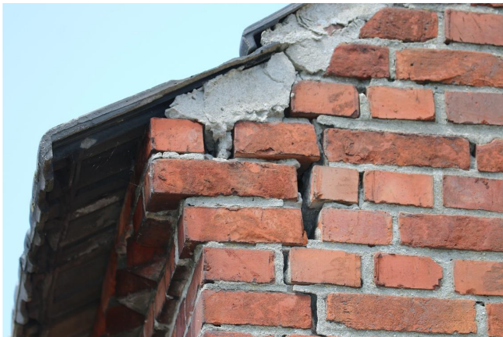
Figuur 17. Er zijn veel scheuren aanwezig in de gevel waardoor geschikte wegkruipmogelijkheden zijn ontstaan voor vleermuizen.
