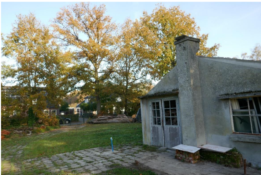
Foto 1: Beeld van de onderzoekslocatie (vervallen huisje)
